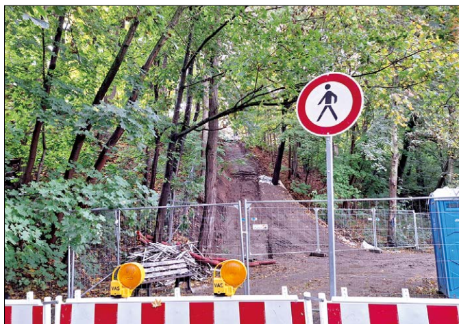
Im Oktober befand sich dort, wo eigentlich die Treppe zur Hohen Straße führt, nur ein schlammiger Abhang. Bild: saho
