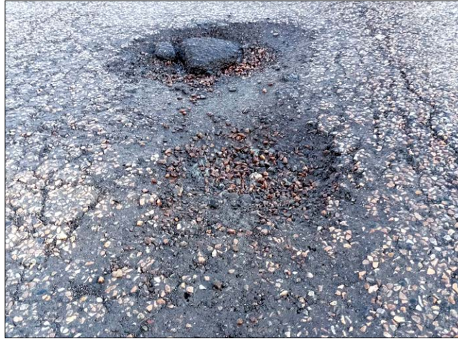
Auch auf der Matthesstraße häufen sich Schlaglöcher. Foto: H.Hofmann
